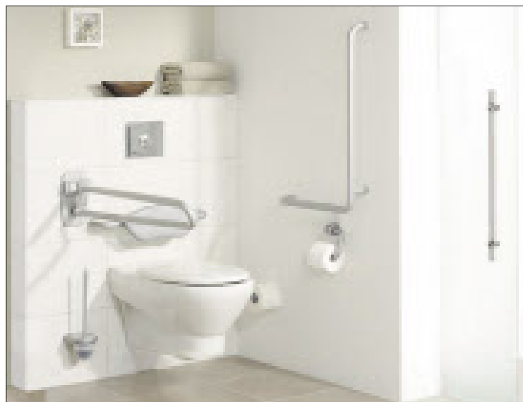
Eine behindertengerechte Toilette ist mit entsprechenden, bakterienhemmend beschichteten Haltegriffen ausgestattet.
